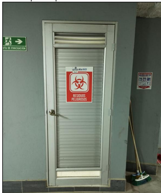
Imagen 2 Cuarto de almacenamiento de residuos peligrosos Casa de Justicia Usaquén
