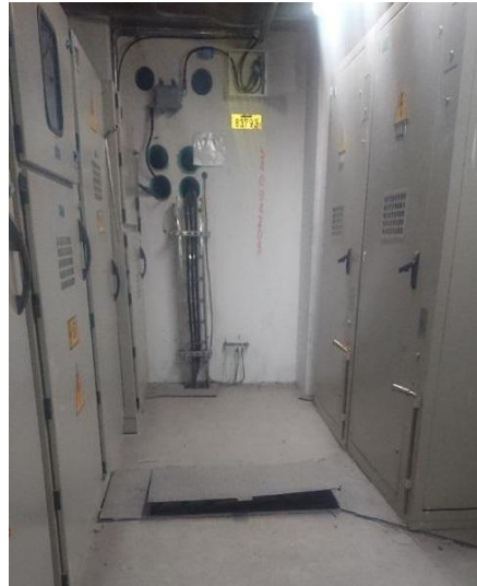
Cuarto alta tensión
