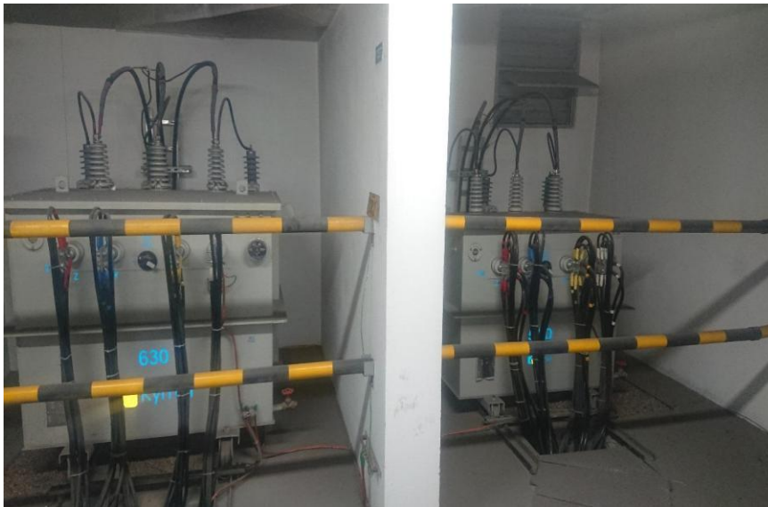
Cuarto de media tensión
